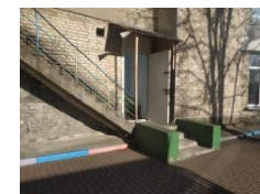
фото №16 Эвакуационный выход 1 группа
